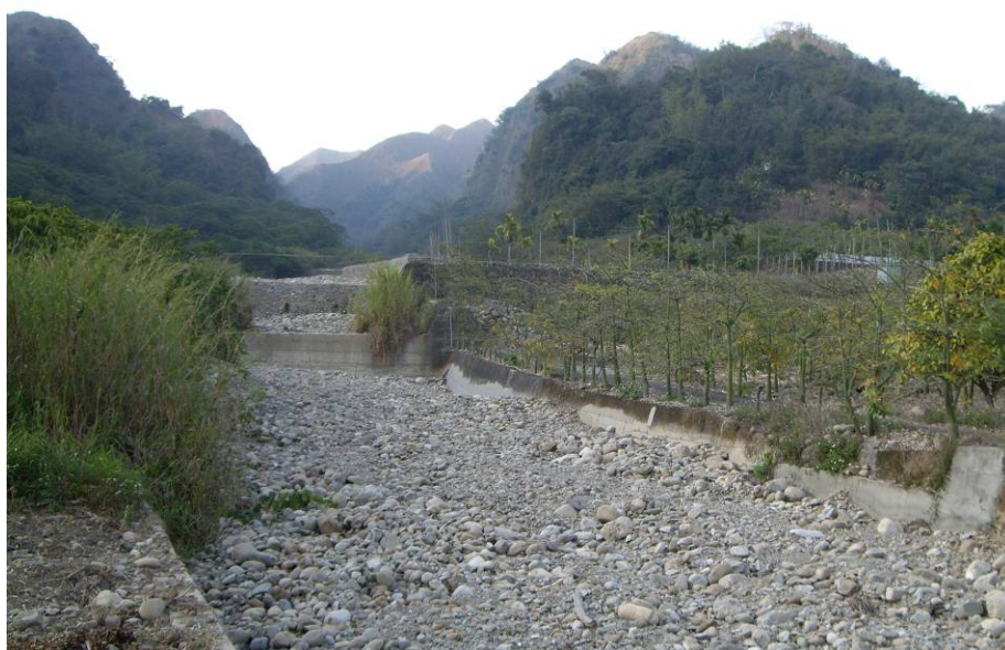
圖 76 田尾坑溪下游攔砂壩堆積情形 (229778,2654944)
