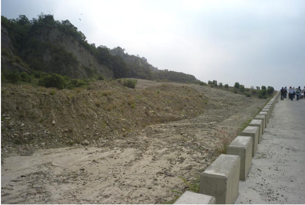
圖 44 隧道西口土堤內側土石堆積情況
