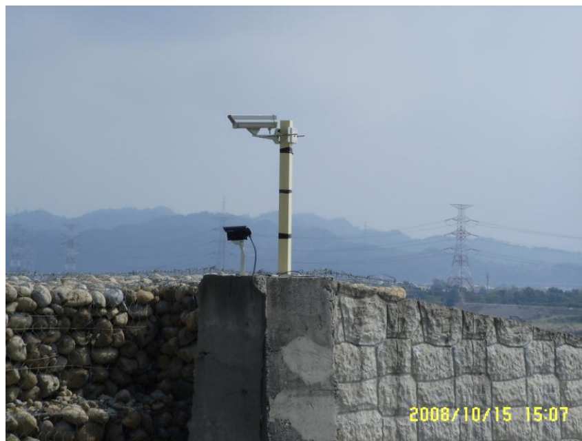
圖 10 西口影像監視器新架設位置 ( 2008/10/15 )
