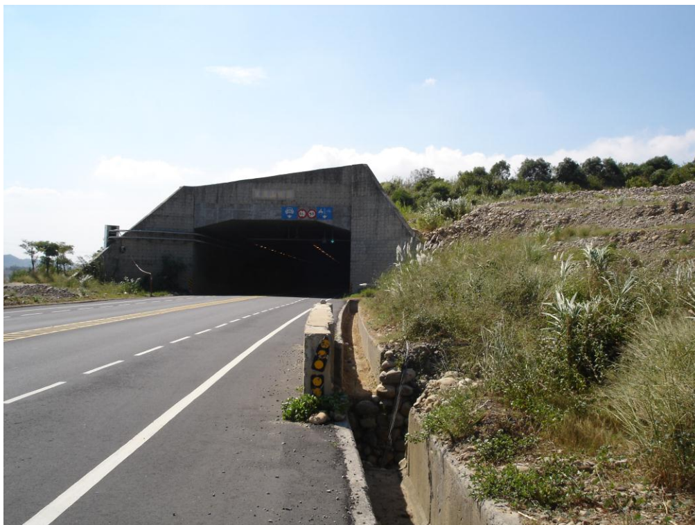
圖 52 莫拉克颱風後火炎山隧道東口情況 1
