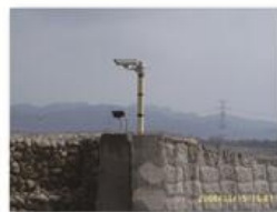
隧道西口影像監視器
