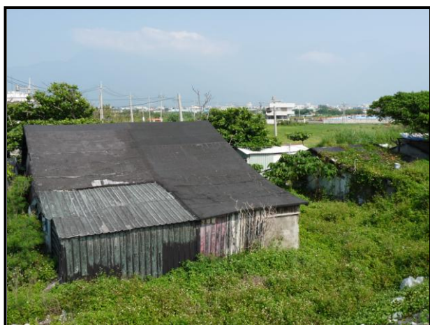
照片 5-5 2602 號違建情形(一)
