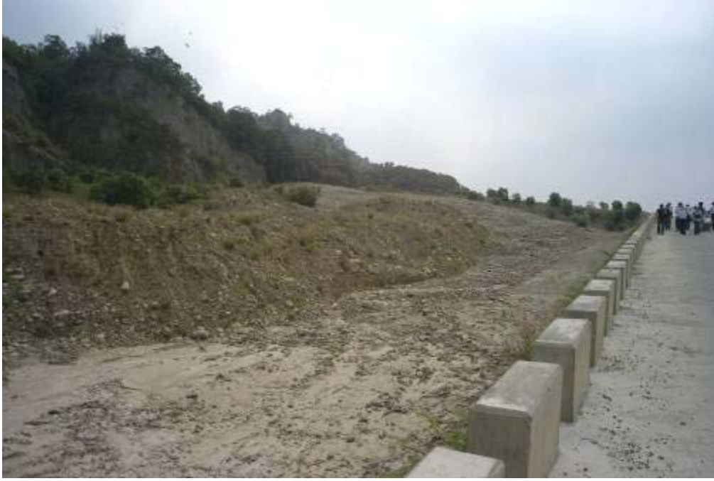
圖 5.22 隧道西口土堤內側土石堆積情況
