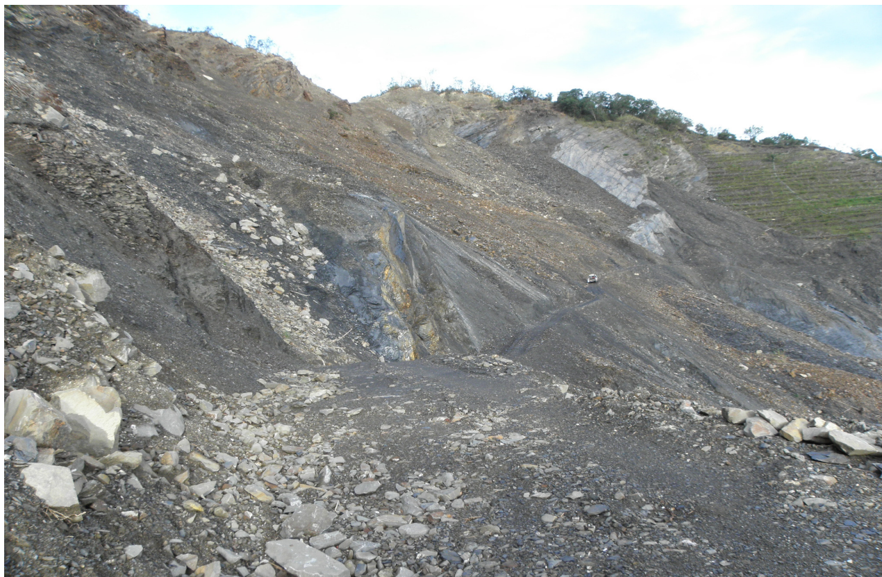
88風災45.5k崩塌處
