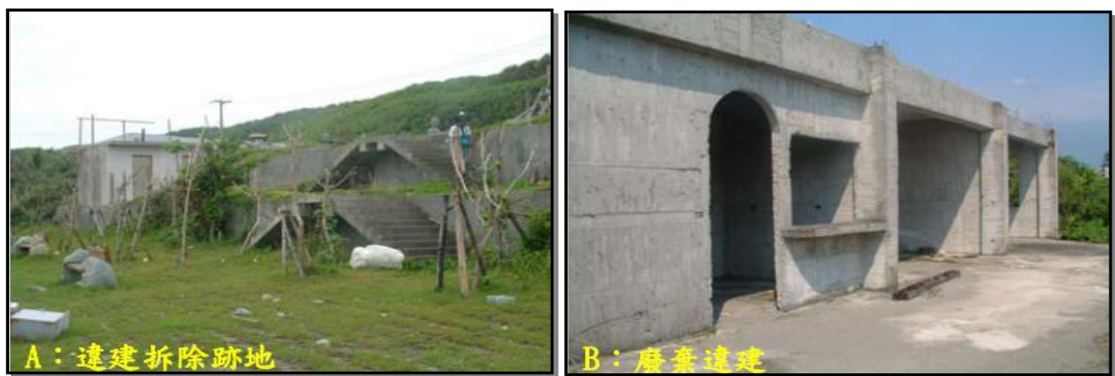
照片 4-7 2613 號保安林非法濫墾及佔用情形
