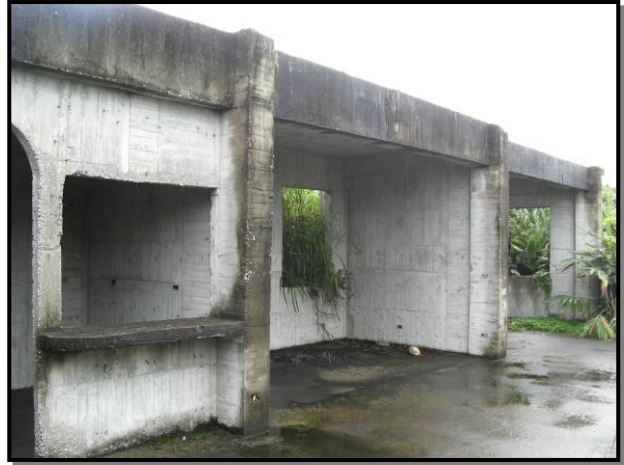
照片5-6 2613號廢棄違建
