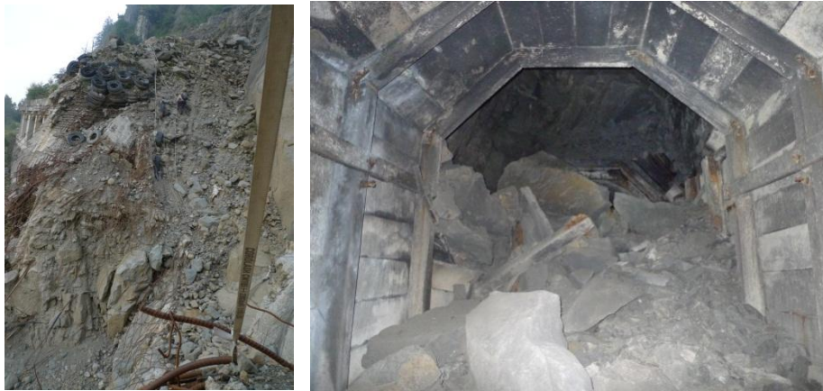
圖 22. 六到八月之連續豪大雨造成崩塌地塌陷更深(左)，以及隧道內的崩塌，增加整體調查之危險性。目前調查團隊一人於石夢谷扭傷，一人於崩塌地摔傷。
