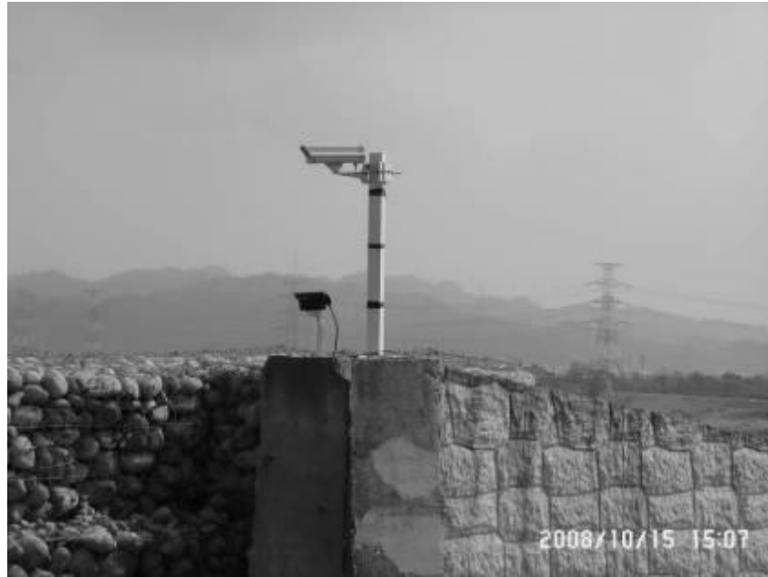
圖 3.16 西口影像監視器新架設位置（2008/10/15）
